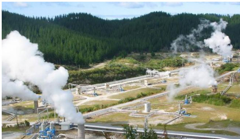
Gambar: Pengembangan Energi Panas Bumi, di Lumut Balai, Sumatera Selatan.
